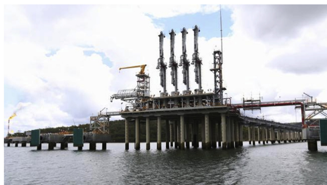
Fig. 2. LNG lines in a harbor.
