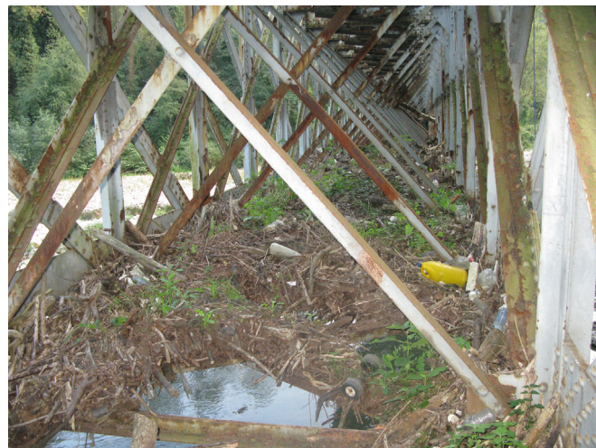
Figura 1. Acumulación de suciedad en el interior de un cajón de un puente ferroviario.
