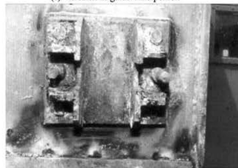
(d) Erosion in intake gate
