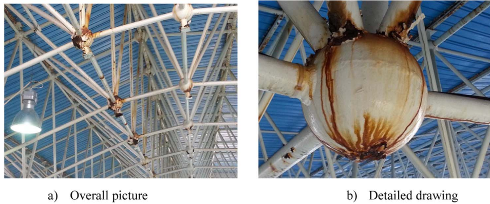
Fig. 1. Corrosion of WHSJ.
